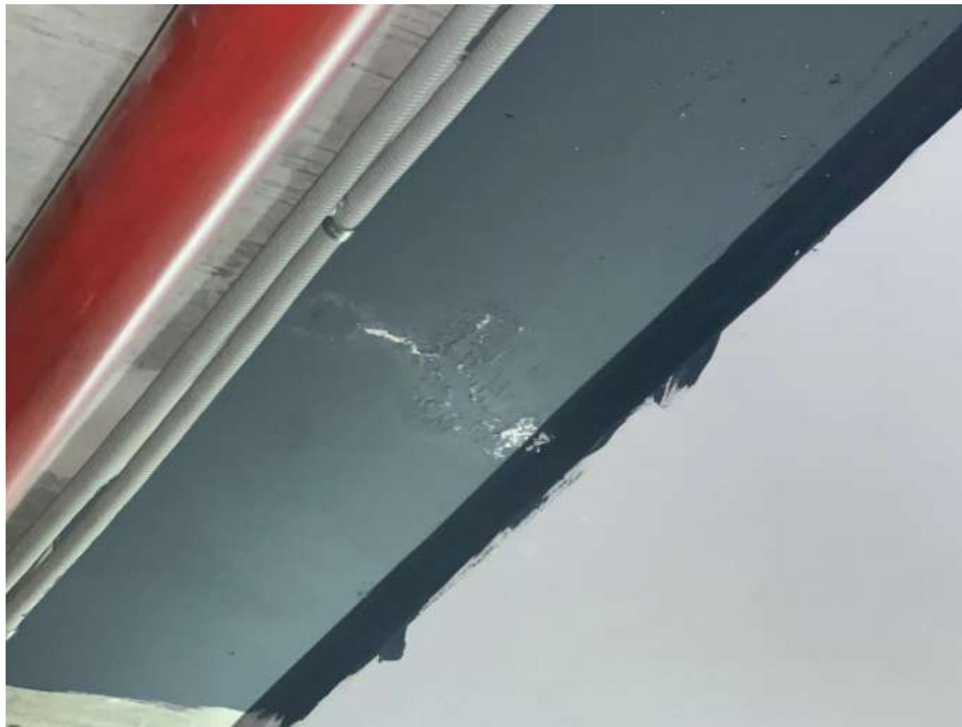
Приложение №2. Фото дефектов
